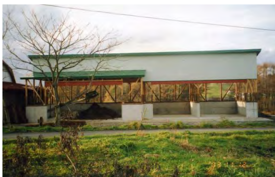
写真 33：整備された堆肥処理施設
