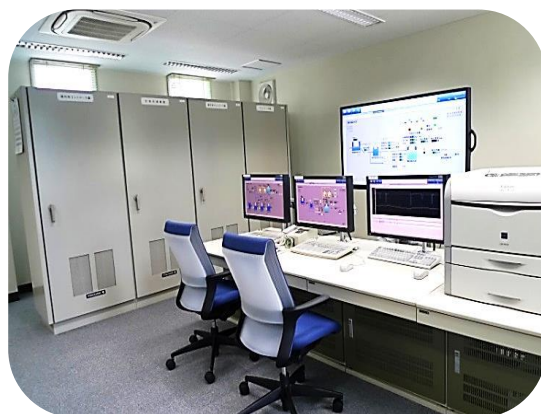
市内各所にある水道施設を集中的に監視する滝沢浄水場の集中監視装置
