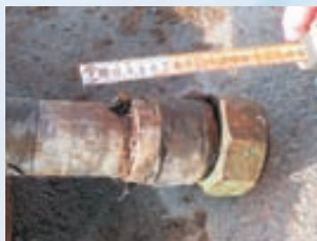
古くなった鉄製の 宅地内給水管が腐 食してきた穴
