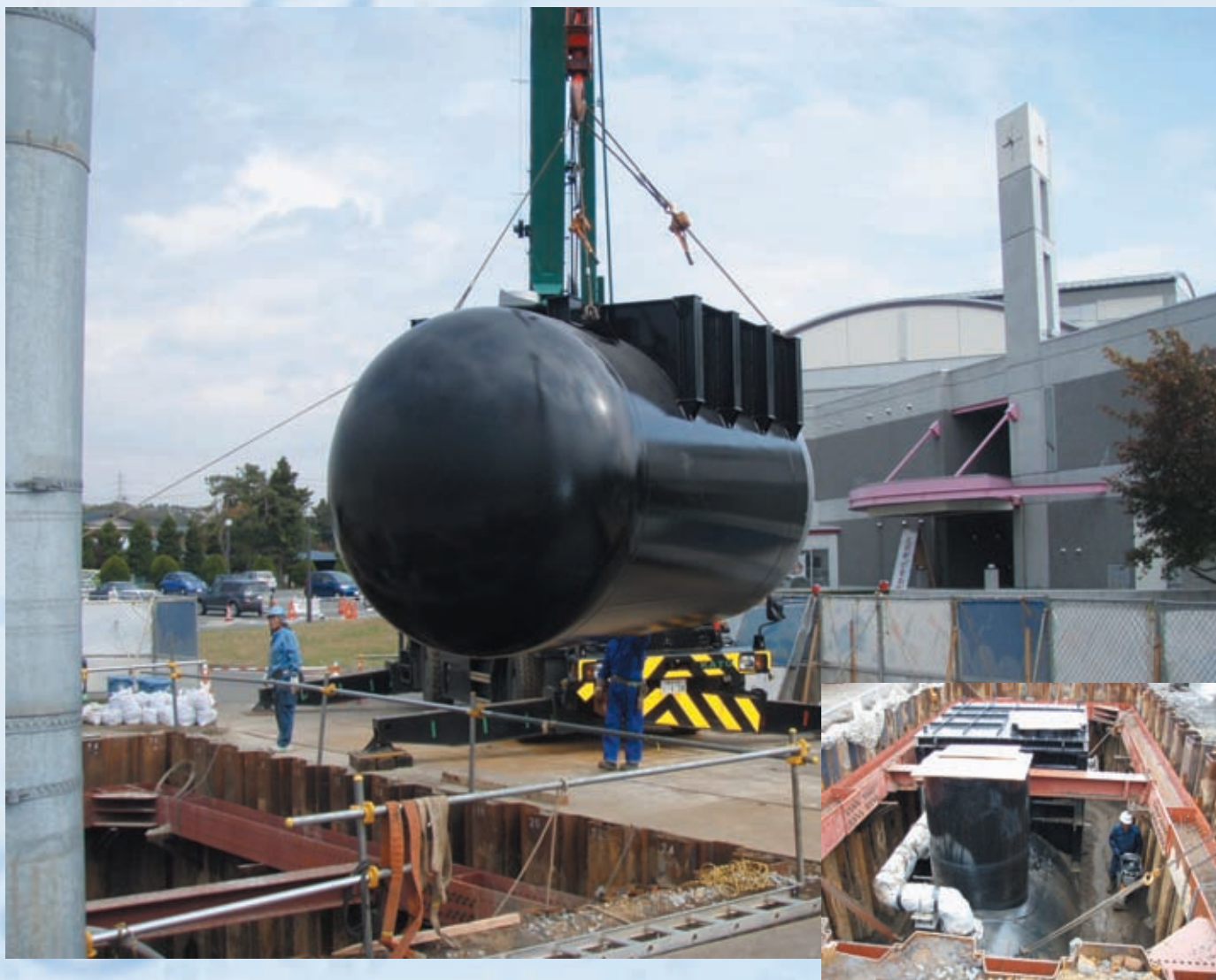
「災害時も安心」 滝沢ふるさと交流館で建設工事が進められている緊急貯水槽
