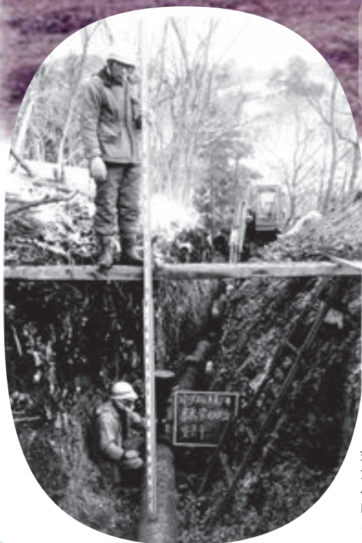
金沢川取水口から滝沢浄水場へ水道管を整備している様子(昭和49年)
