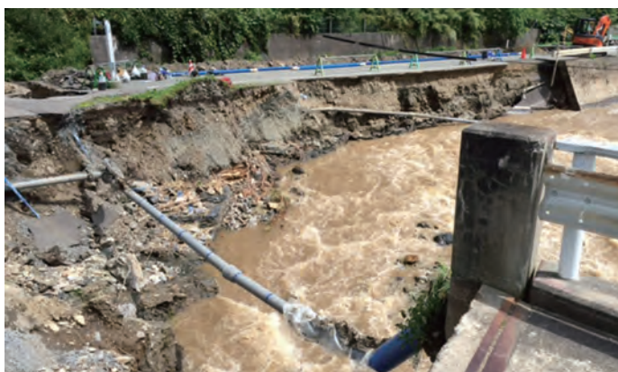
↑写真上 道路が崩落しても抜けなかった地震に強い水道管(葛巻町)
