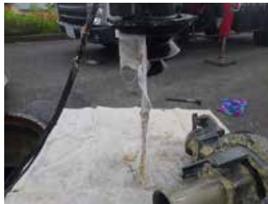
△実際に詰まった時の写真 原因：タオルによる詰まり
