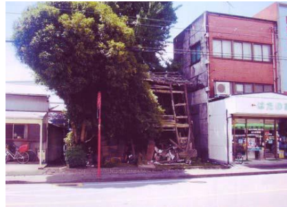
図 29：建築物や立木が近隣や道路に著しく傾斜し、放置されている状態
