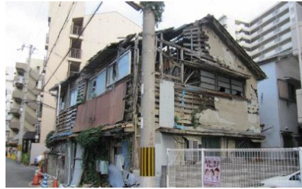
図28：外壁が外見上大きく傷み、窓ガラスが割れたまま放置され景観を損なっている状態
