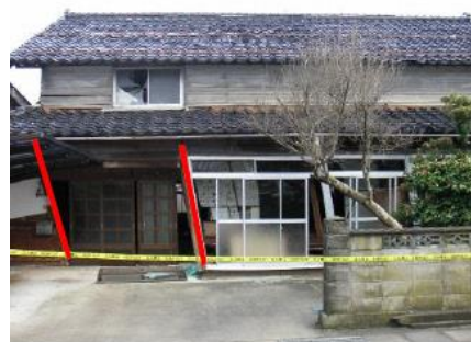
図 26:一階部分が傾斜し倒壊等のおそれがある状態
