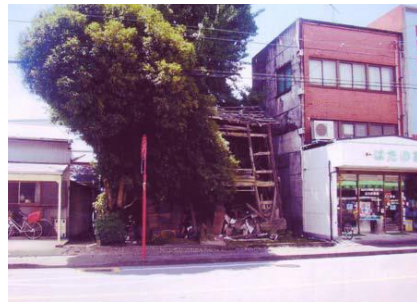
図 29:建築物や立木が近隣や道路に著しく傾斜し、放置されている状態
