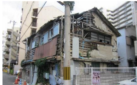
図28:外壁が外見上大きく傷み、窓ガラスが割れたまま放置され景観を損なっている状態
