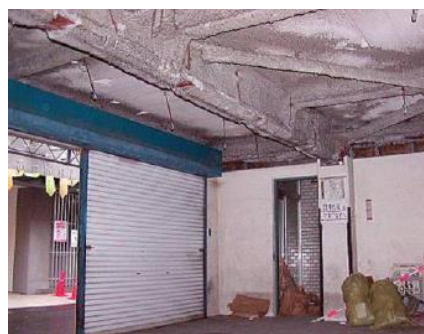
図 27：吹付け石綿等が飛散し暴露する可能性が高く衛生上有害となる状態
