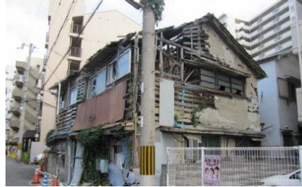
図28:外壁が外見上大きく傷み、窓ガラスが割れたまま放置され景観を損なっている状態
