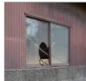
窓が割れた管理不全空家
