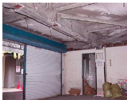
図 27：吹付け石綿等が飛散し暴露する可能性が高く衛生上有害となる状態
