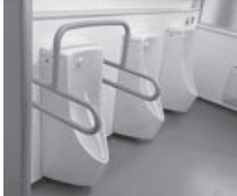
手すり付小便器（一本木中学校）
