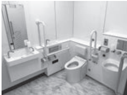
バリアフリートイレ （滝沢第二中学校）
